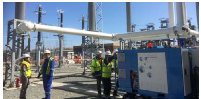
Image 10 : Opération de remplissage du g 3 de la ligne à isolation gazeuse 420 kV au poste de Sellindge de National Grid, Royaume-Uni
