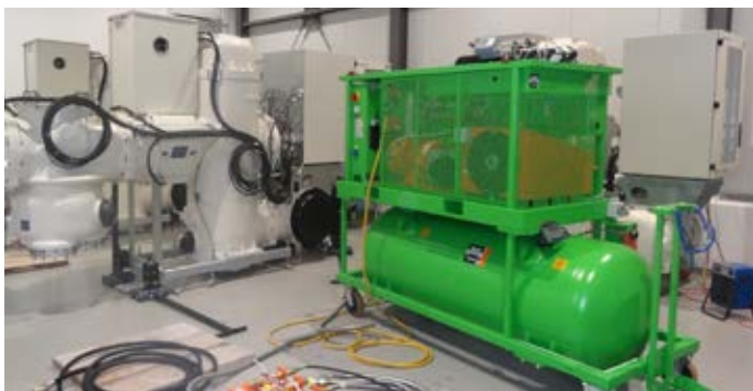
Image 13 : Chariot de service DIL0 dédié au g^3 -utilisé sur le poste d'Etzel d'Axpo
